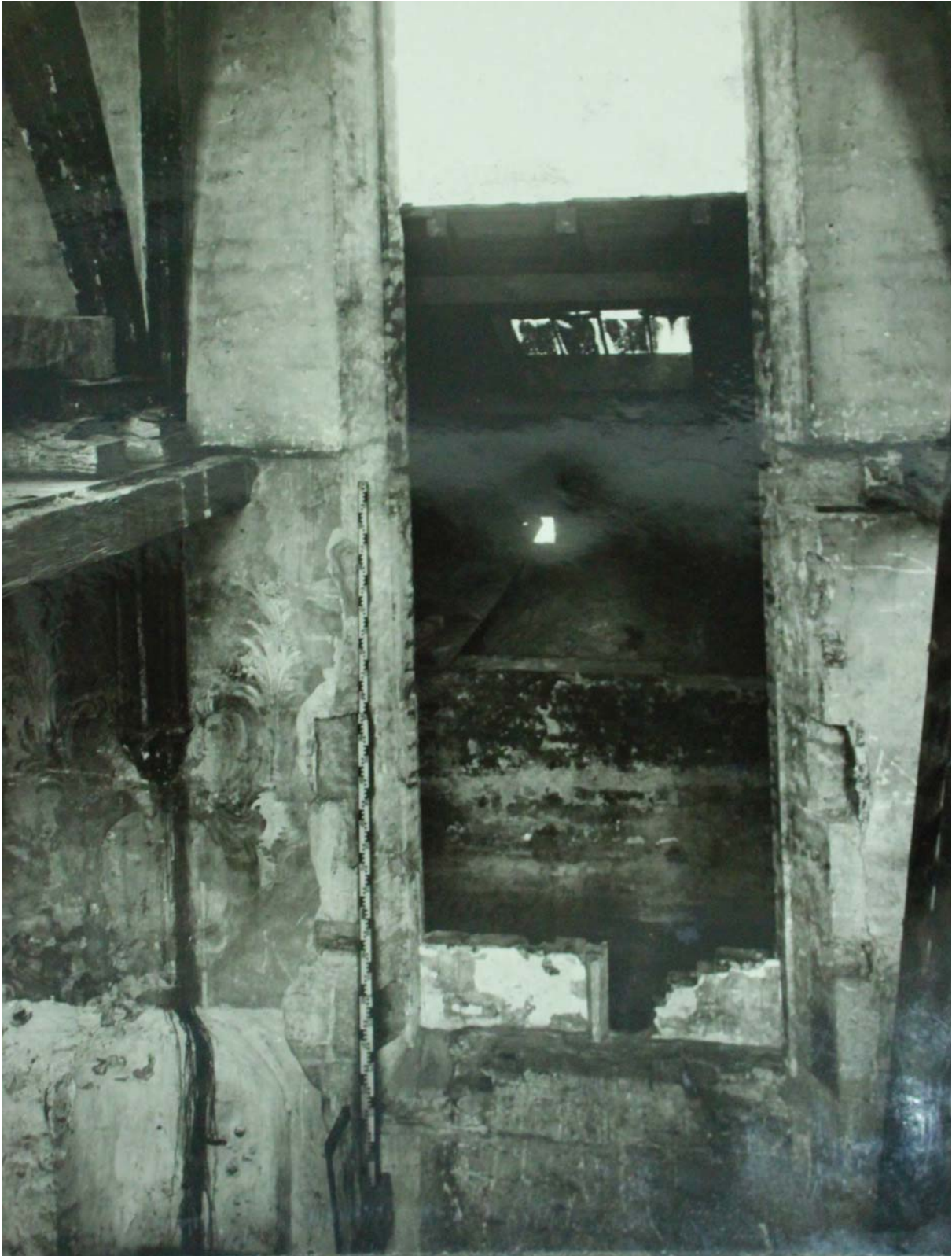
Abb. 98: Ehemalige Kartäuserkirche St. Barbara – Türdurchbruch zum Dachstuhl der Seitenkapelle Nordwestliche Ecke oberhalb des Emporenniveaus – vermutlich zwischen 1919 und 1928 Archivalie des EGAK – ohne Inventarnummer
