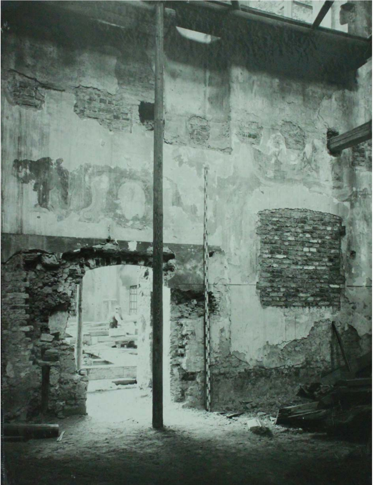
Abb. 96: Ehemalige Kartäuserkirche St. Barbara – Türdurchbruch zum Kreuzgang in der Südwand vermutlich zwischen 1919 und 1928 Archivalie des EGAK – ohne Inventarnummer
